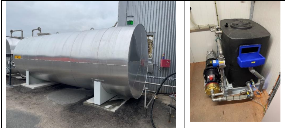
Figuur 8: Tank met additief (links) en Mengen water en additief (rechts)
