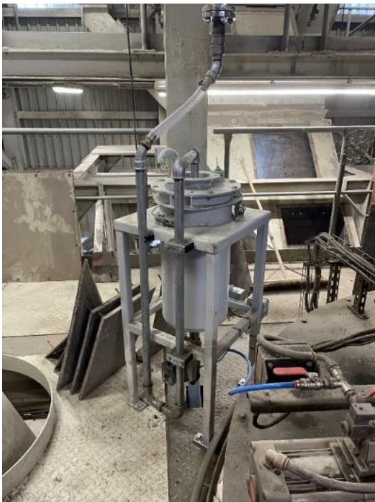
Figuur 10: Doseerinstallatie bij de menger
